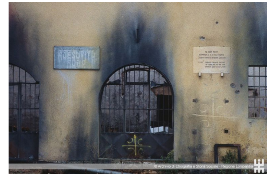
Edificio danneggiato durante la guerra dei Balcani ITE-OPD00-0000091799
